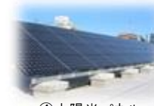
④太陽光パネル
